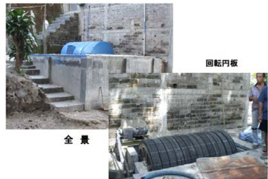
クリチャック地区のコミュニティ排水処理設備
