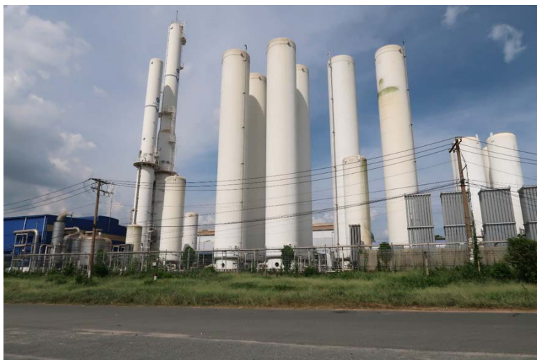
図 7-7. フーミー第 1~4 発電所近くに新規建設された LNG 貯蔵タンク (注 13)
